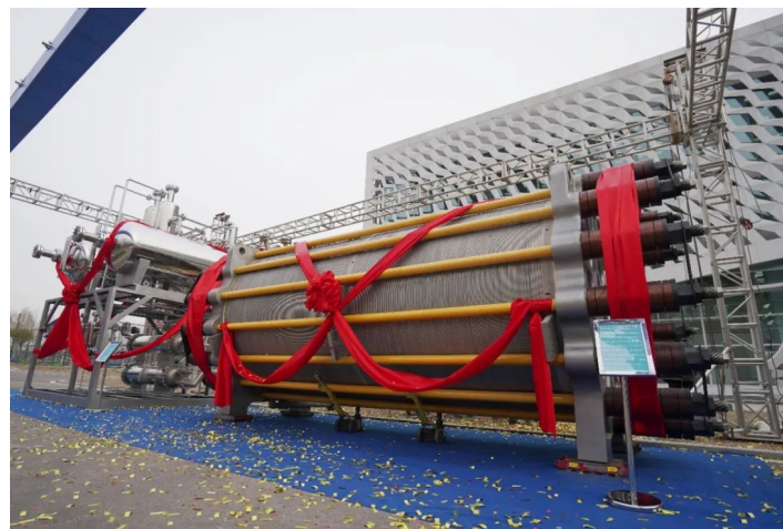
Abb. 9: Erste großindustrielle Wasserstoffproduktionsanlage in China ( https://www.fuelcellchina.com/Industry_information_details/109.html )
